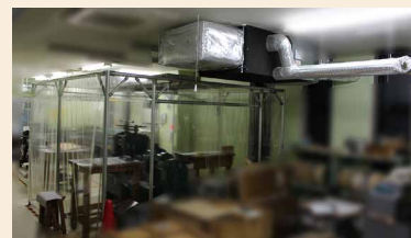
設置した局所給排気設備
