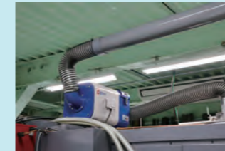
ミストレーサーの設置
