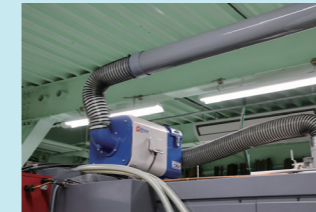
ミストレーサーの設置
